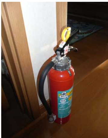
共用部分に設置された消火器
